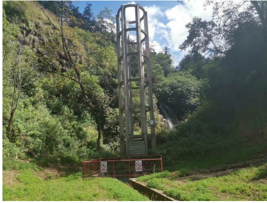
尾矿库上游排水井
