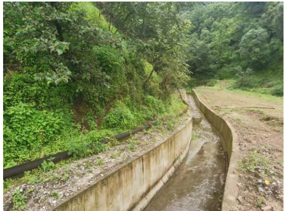
排土场西侧截排水沟
