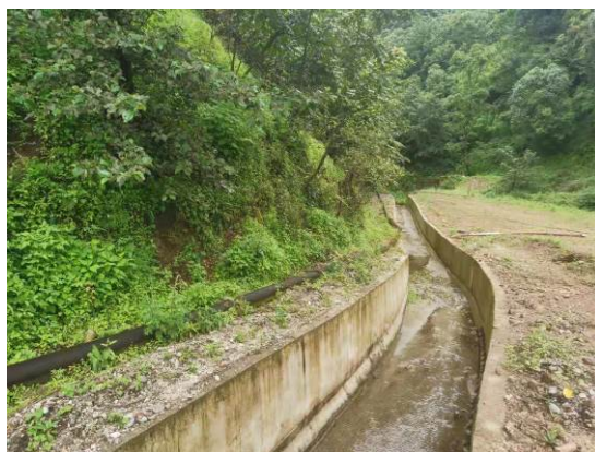
排土场西侧截排水沟
